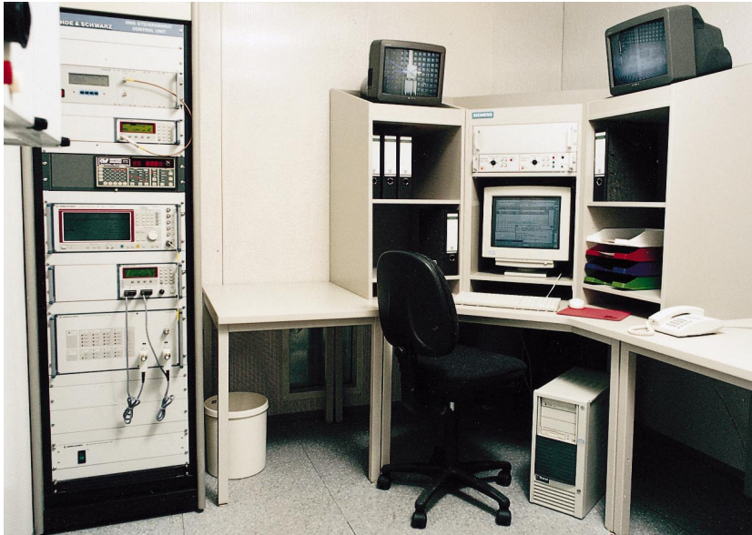
BILD 1 EMV-Testsystem der Technischen Überwachung Hessen.
